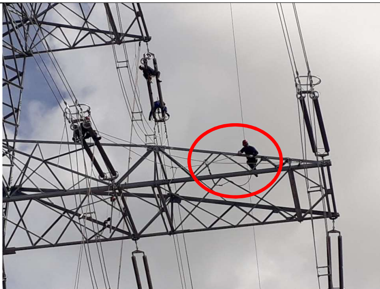
Imagem 07 – Detalhe da condição de perigo (foto João Marcelo Saraiva).
